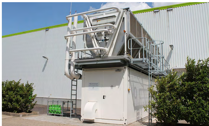
Der Süßwarenhersteller Katjes erhielt von Johnson Controls im Frühjahr 2018 den weltweit ersten Kälte-Technikcontainer.
