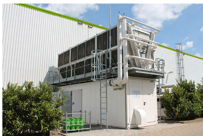
Die Kältezentrale als praktische Containerlösung benötigt kaum Stellfläche.
